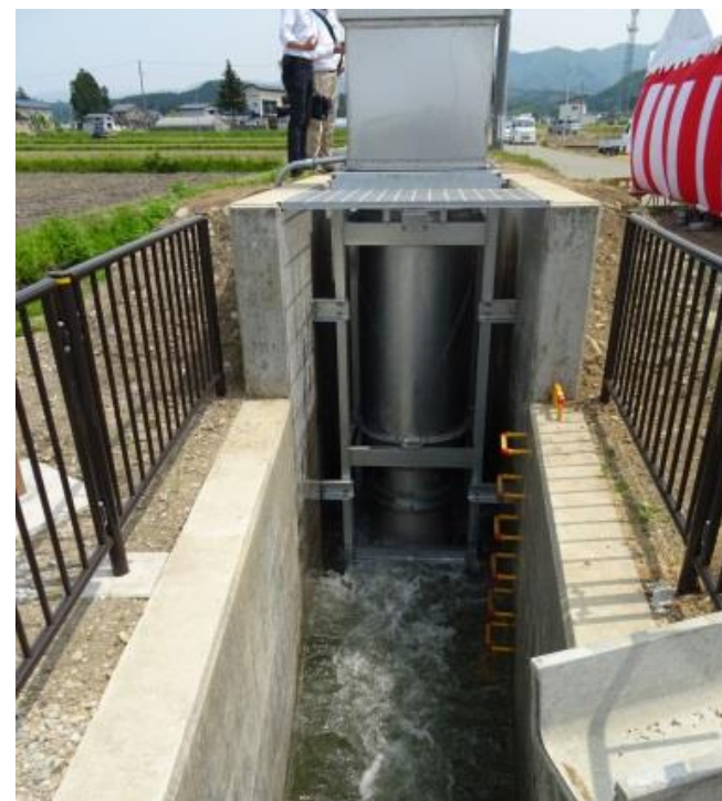
六郷東根小水力発電所（美郷町）（出力11kW）
