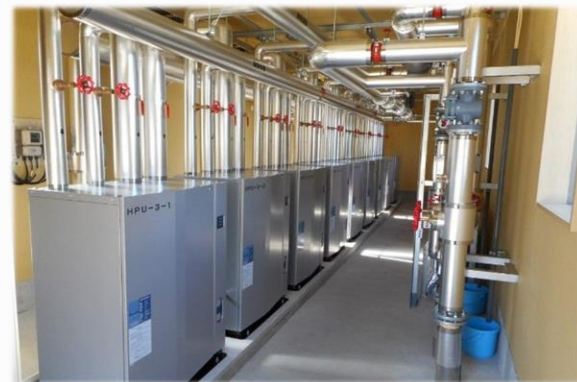
ヒートポンプ設置状況
